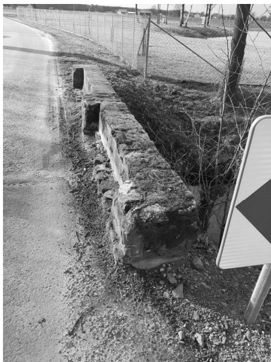
FOT.3 – Widok na uszkodzenia konstrukcji przyczółka istniejącego przepustu
